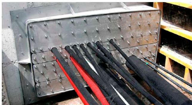
zastosowano kołnierz stalowy z gumowym wkładem uszczelniającym w wykonaniu dzielonym.
