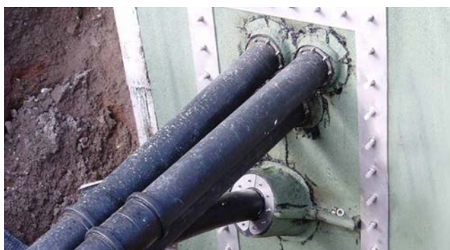
zastosowano kołnierz stalowy oraz gumowe wkłady uszczelniające zgodnie z normą DIN 18533.
