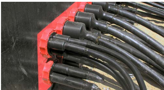
wejście stacji: Przewód niskiego napięcia uszczelniony za pomocą HSI 90-D1/75 oraz HSI 90-D3/32
