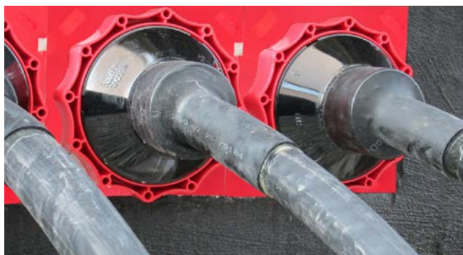
wejście stacji: Przewód niskiego napięcia uszczelniony za pomocą HSI 150-D1/80
