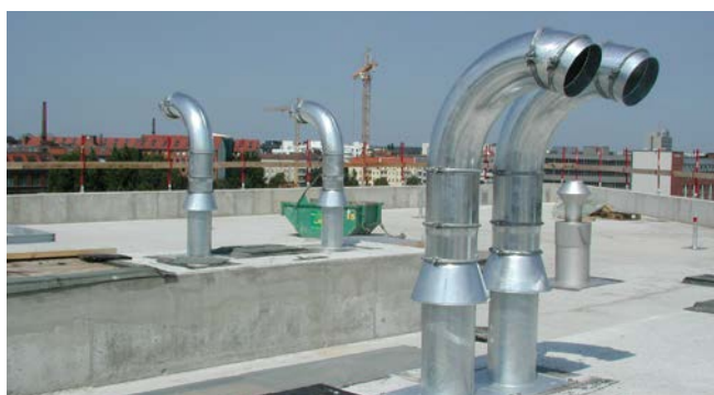
zamontowane przepusty SHD 200, bez kabli
