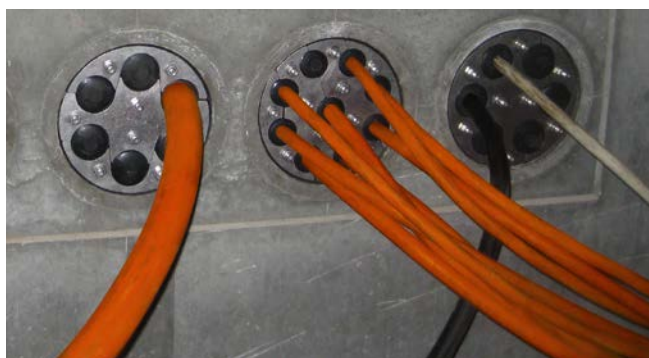
HRD 150-SG – uszczelnione kable w odwiercie w ścianie betonowej
